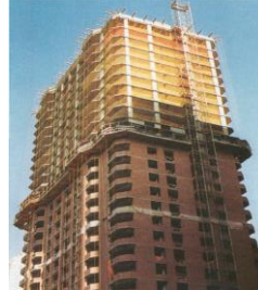
(شكل رقم 2) يوضح استخدام هيكل من الخرسانة المسلحة R.C من أعمدة وكمرات وبلاطات أسقف في النظام الإنشائي للمبنى العالى المصدر مرجع [1]
