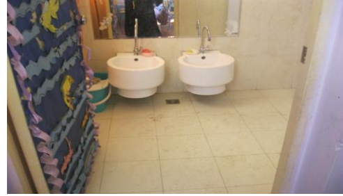
شكل رقم (43) أحواض غسل الأيدي في دورة مياه رياض الأطفال بمدرسة مصر الحرة التجريبية للغات بالمنوفية المصدر : الباحثة
